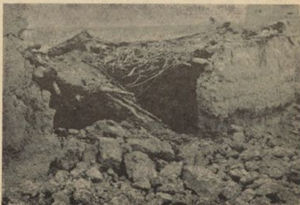
صحنه یی از خرابی زلزله دواشکمش
